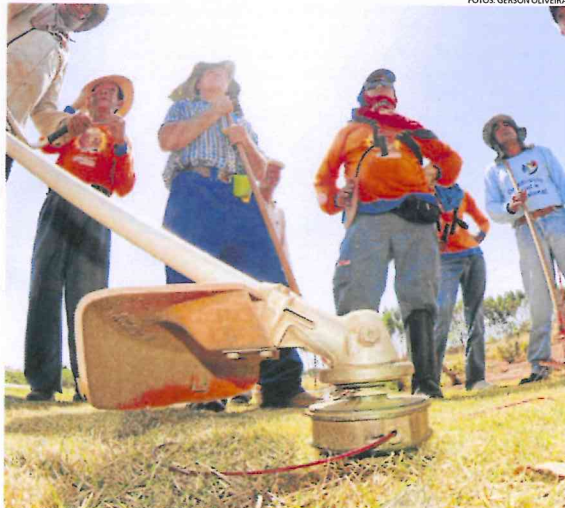
Frente de trabalho. Trabalhadores temporários limpam canteiros de avenidas, praças e rotatórias
