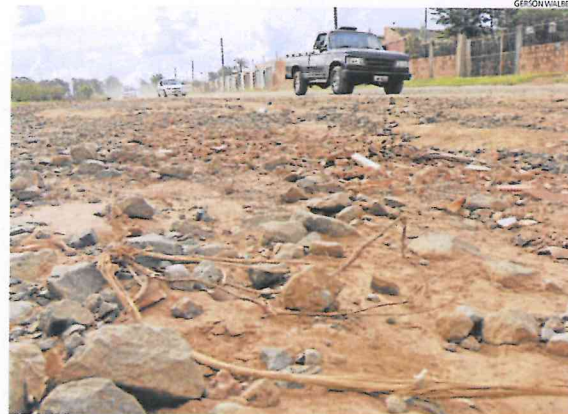
Vias sem asfalto. Ruas como esta, do Bairro Santa Emília, estão no plano de manutenção do município
